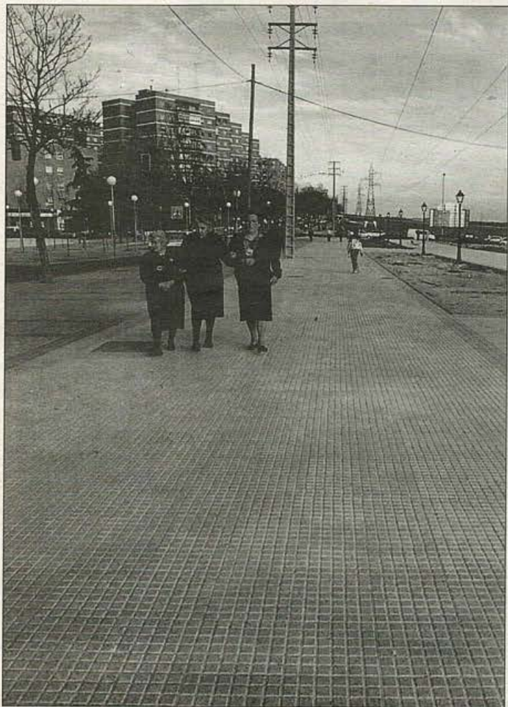
Las obras de remodelación de la Avenida del Oeste junto con la calle los Cantos están previstas que finalicen para los últimos días de abril.
