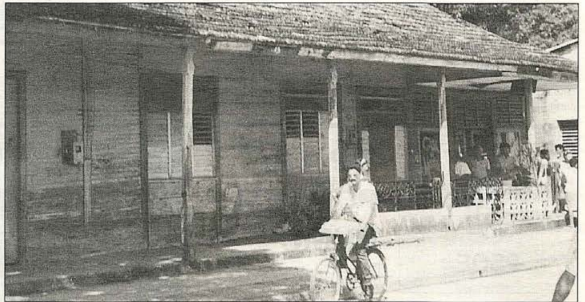
Estado general de paredes y techo en un edificio de Mayarí. En la foto superior, Casa-Consultorio de médico rural
