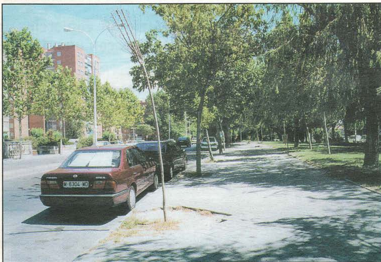
Una de las aceras deterioradas que dificultan el paseo en la avenida del Alcalde José Aranda
