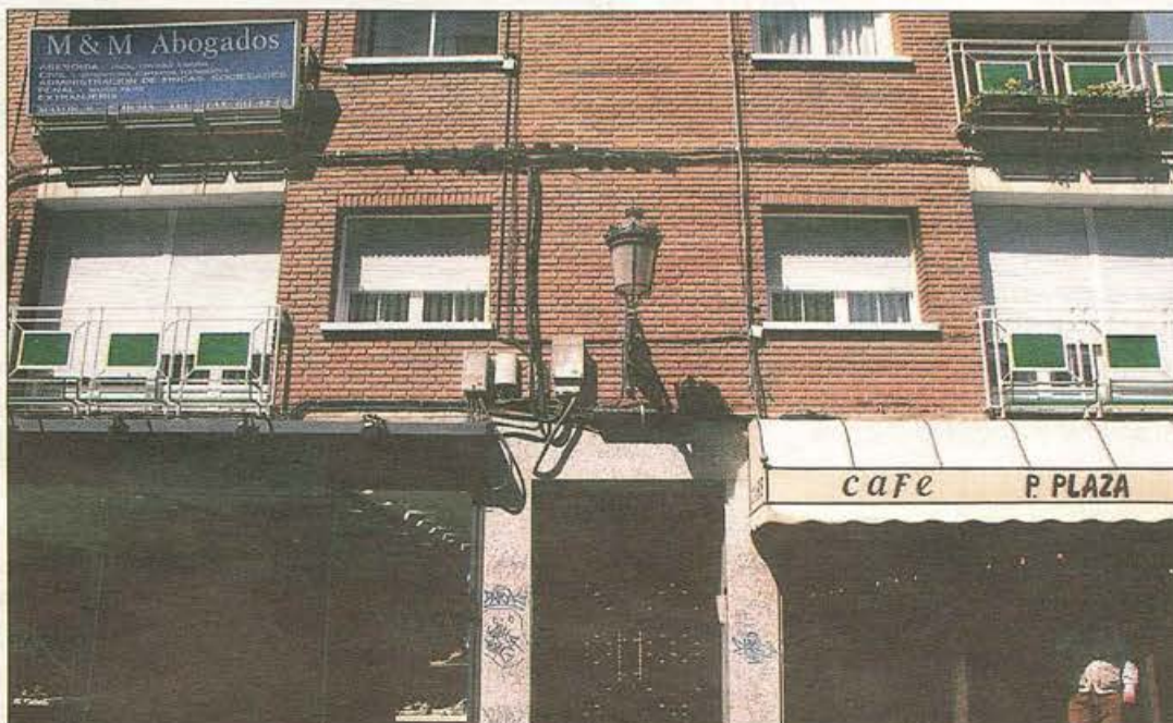
El Ayuntamiento cederá una porción de la vía pública para poder realizar las obras
