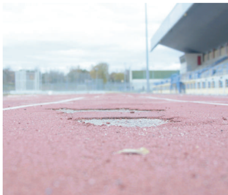
La pista de atletismo presenta un gran deterioro
