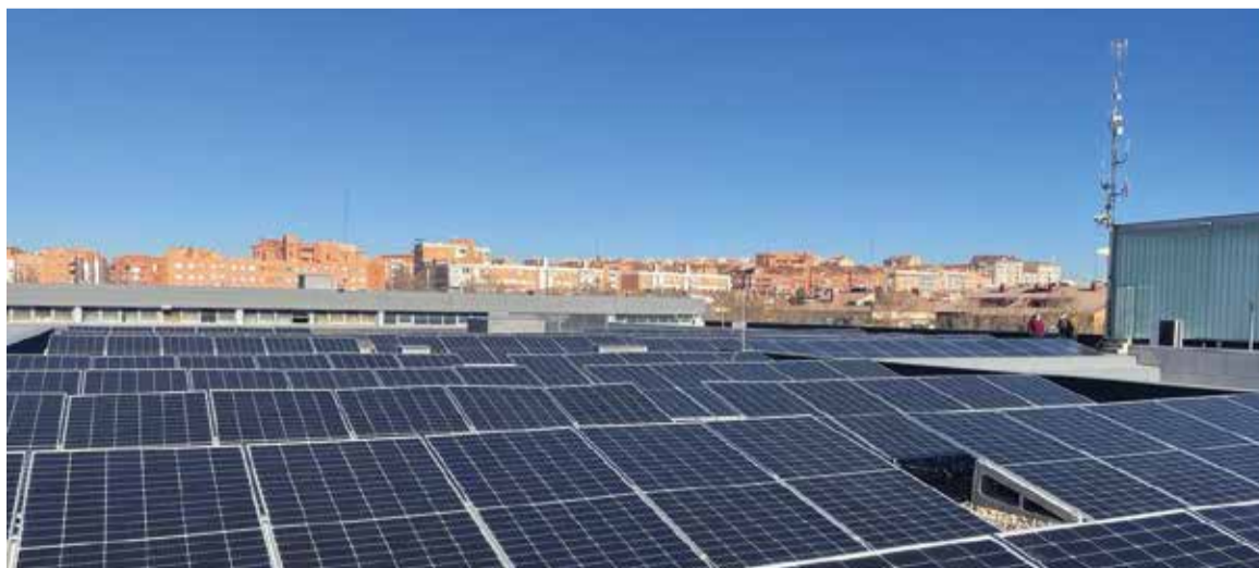
Placas de energía solar fotovoltaica en la cubierta del Centro Unificado de Seguridad (CUS)
