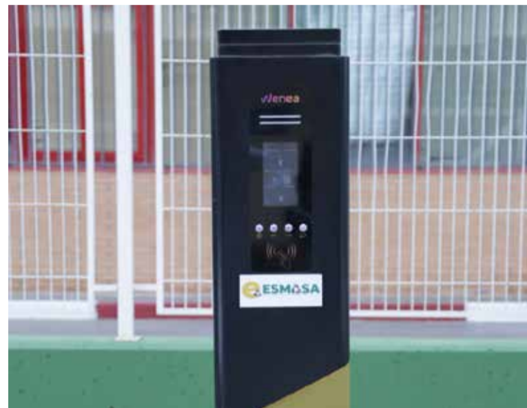
Punto de carga para los coches eléctricos
